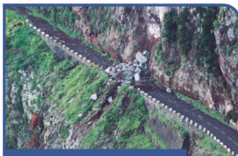
› Deslave de cerro por las lluvias
