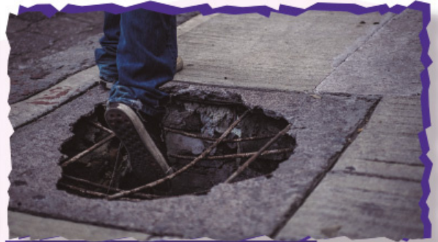
➤ Falta de mantenimiento de una coladera
