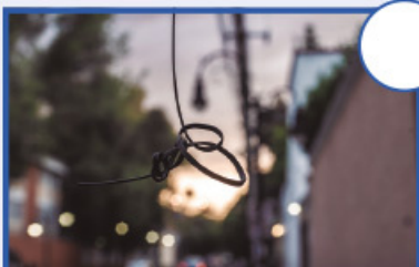
› Cables caídos en la vía pública por lluvia en la alcaldía Coyoacán
