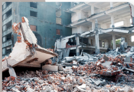
► Derrumbes en la Ciudad de México
