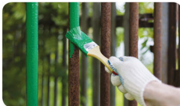
Figura 1.42 Para evitar el deterioro del hierro en estructuras de uso cotidiano, es necesario recubrirlo con materiales resistentes a la corrosión, como la pintura y el barniz.
